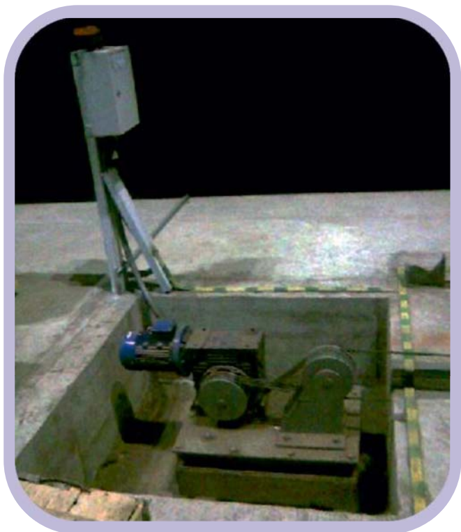
Тросовый привод с лебедкой и эл. шкафом с ДУ
