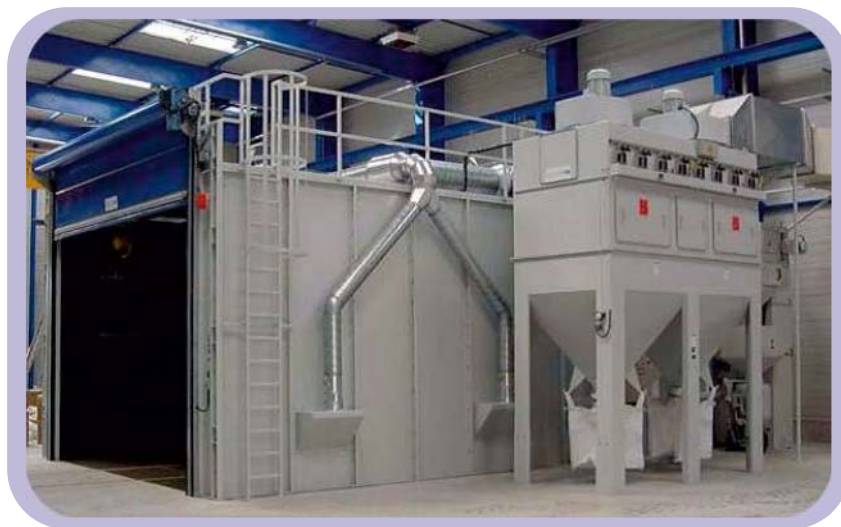
Пример. Общий вид Дробеструйная камера с фильтровентиляционными установками.
