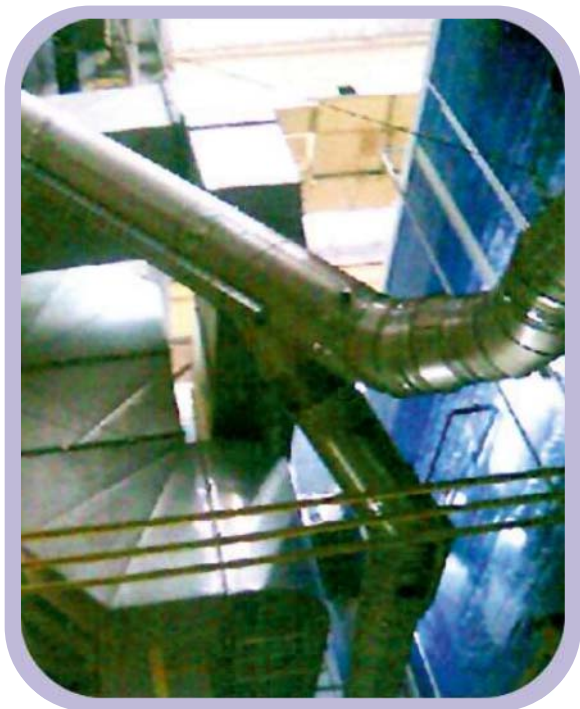
Воздуховоды и дымоход внутри цеха.
